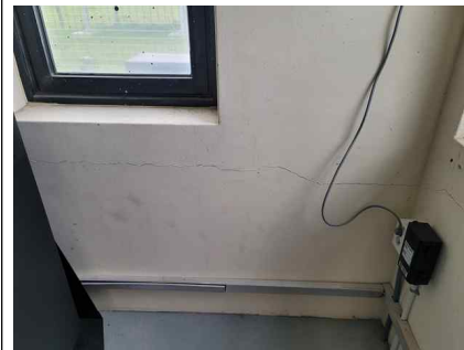
<제어실 내부 벽체 균열>
