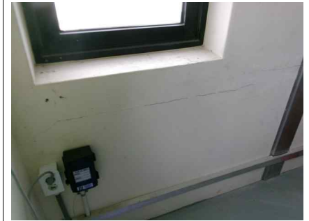
<제어실 내부 벽체 균열>
