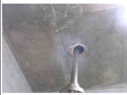
<유입밸브실(1지) 상부슬래브 백태>
