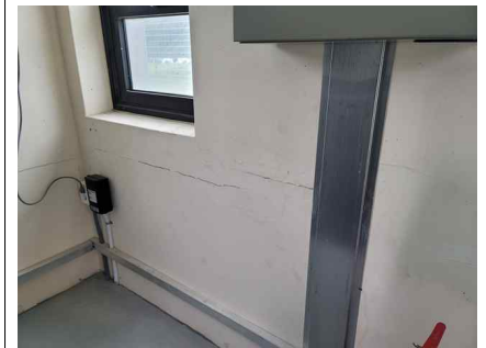
<제어실 내부 벽체 균열>
