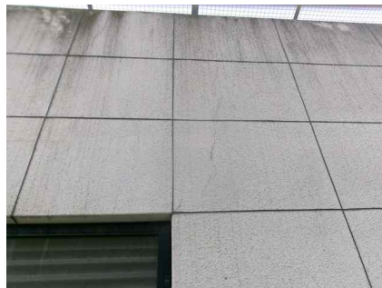
<검수실 외부 벽체 균열>
