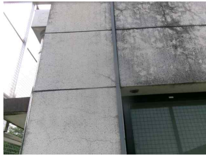
<검수실 외부 벽체 균열>
