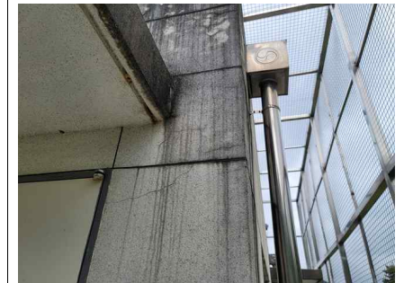
<검수실 외부 벽체 망상균열>
