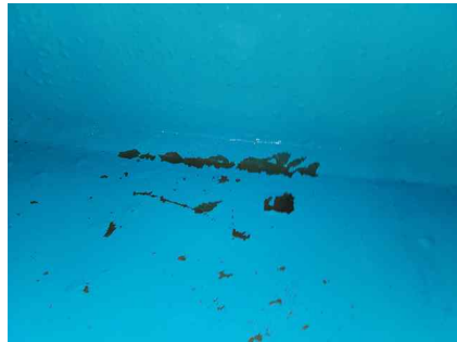
<배수지 1지 바닥슬래브 도장박리>
