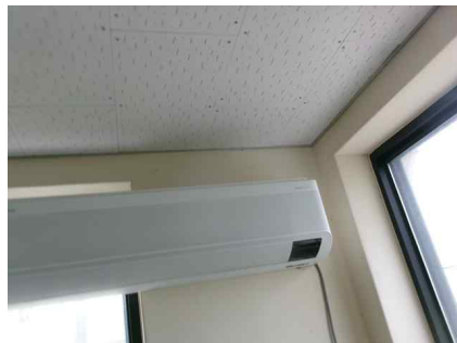
<제어실 내부 벽체 균열>
