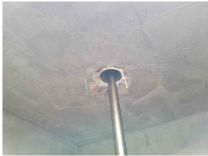
<유입밸브실(2지) 상부슬래브 백태>
