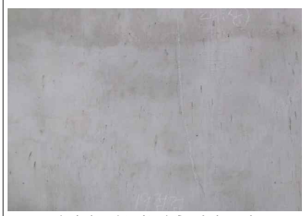
<유입밸브실(1지) 우측 벽체 균열>
