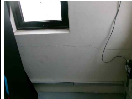
<제어실 내부 벽체 균열>
