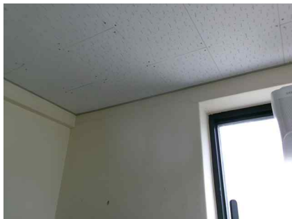
<제어실 내부 벽체 균열>
