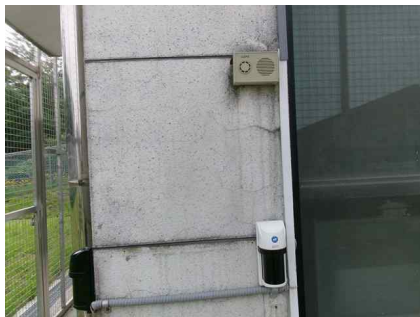
<검수실 외부 벽체 균열>
