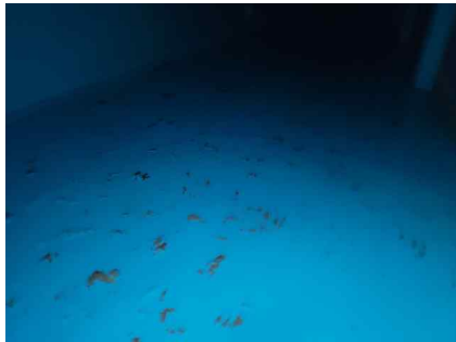
<배수지 1지 바닥슬래브 도장박리>
