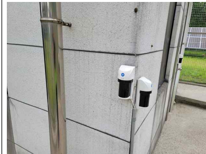
<검수실 외부 벽체 균열>
